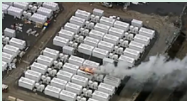
Figura 2: Incendio en las instalaciones de la Gran Batería de Victoria, cerca de Geelong (Australia) el 29 de julio de 2021. El incendio se produjo durante las pruebas de un megapack de baterías. Crédito: Fire Rescue Victoria
