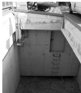
Fig. 5.1 Local tècnic d'una instal·lació domèstica de caldera de biomassa amb sitja tèxtil
