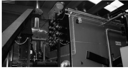
Fig. 3.5. Vista del local tècnic d'una instal·lació de calefacció de barri de 2 MW amb biomassa, a Molins de Rei.
