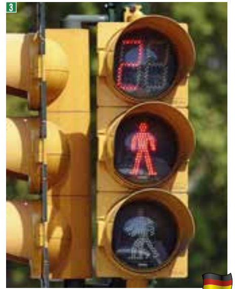
Semaforo pedonale con display esteso di tempo residuo per la luce rossa
