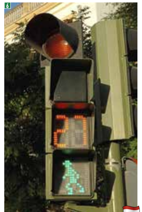
Semáforo peatonal con fase amarilla para el "desalojo"
