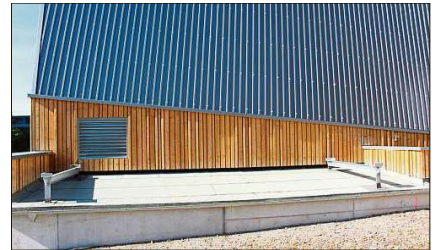
Vorgesehener Standort für die Wärmepumpe. Foto: Küncke
