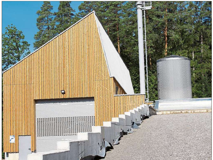
Die Heizzentrale versorgt bereits heute große Teile des »Bioenergiedorfs« Wart.
